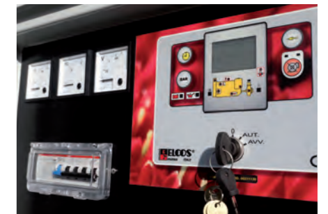
Quadro con amperometro, voltmetro e frequenzimetro Control panel with ammeter voltmeter and frequency Panneau de commande avec ampèremètre voltmètre et fréquencemètre.
